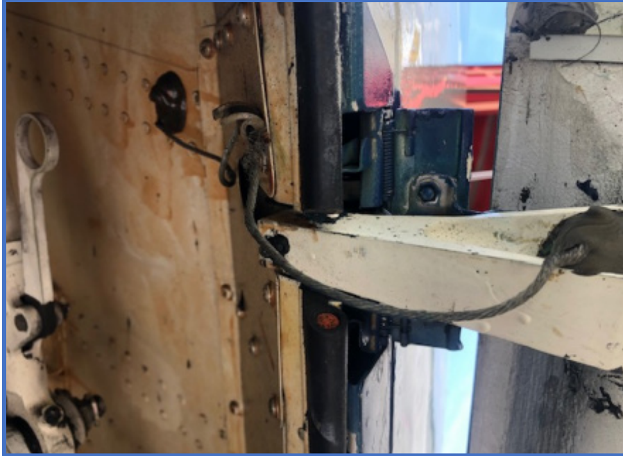
Imagen No. 6: NLG LH DOOR, Bonding Wire
